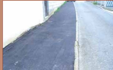
Réfection d'une partie de trottoir rue de la Genestraye, ces travaux seront complétés par la pose de barrières.
