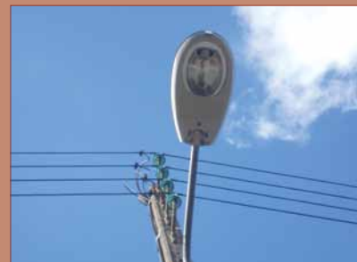
Remplacement des éclairages rues Verdun, A. Vassord et une partie de la rue de la Guillotte (entreprise ELALE)
