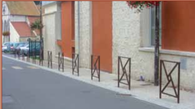
Pose de barrières sur le trottoir rue du Terre afin d'empêcher le stationnement.
