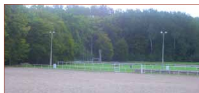
Poteaux éclairage terrain stabilisé, penchant dangereusement donc 5 poteaux ont été redressés et un mètre cube de béton a chaque poteaux ont été nécessaire pour garantir leurs stabilisées.
